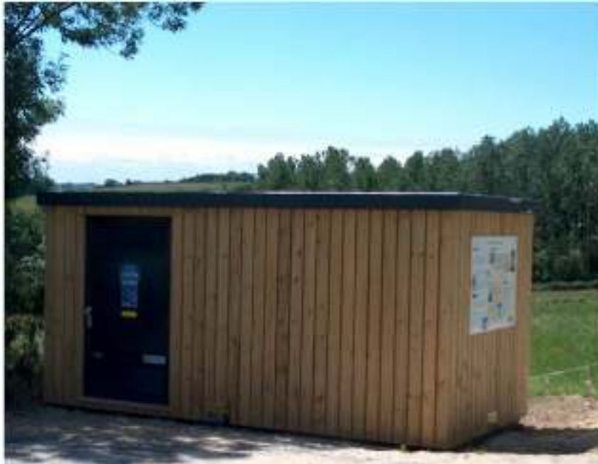
Figure 32 : Illustration d'un poste de livraison du parc éolien (source : VALECO, 2017)
